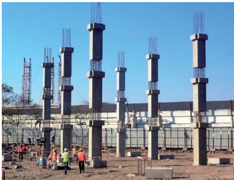
Slika 51: Ostavljeni otvori u predgotovljenim stupovima [11]
