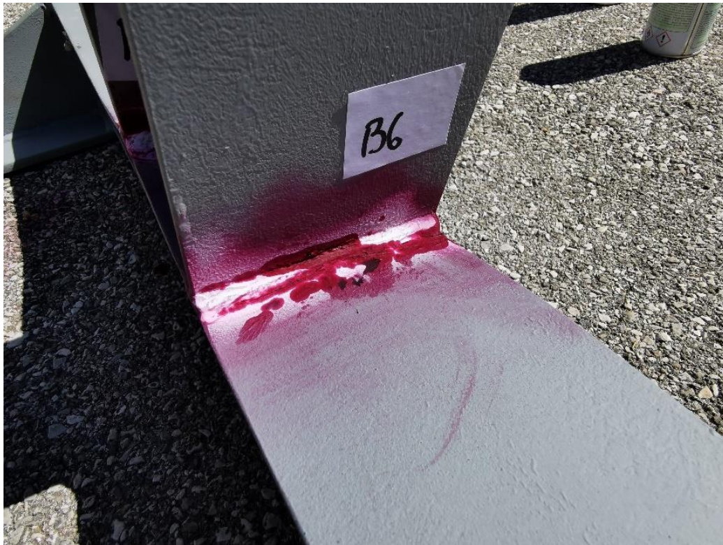
Slika 41: Velika pukotina na zavaru B6 (Izradio autor)
