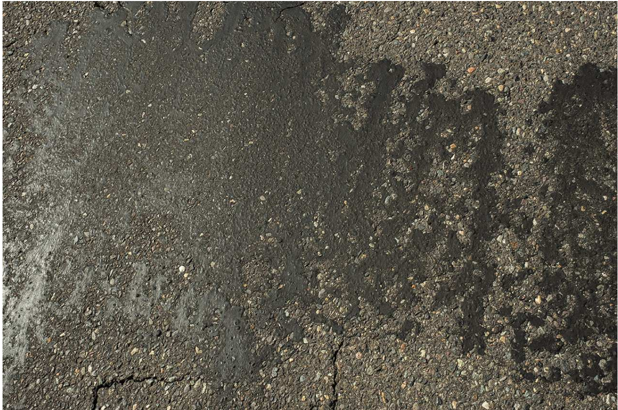
Slika 9. Višak bitumena u smjesi asfalta [11]
