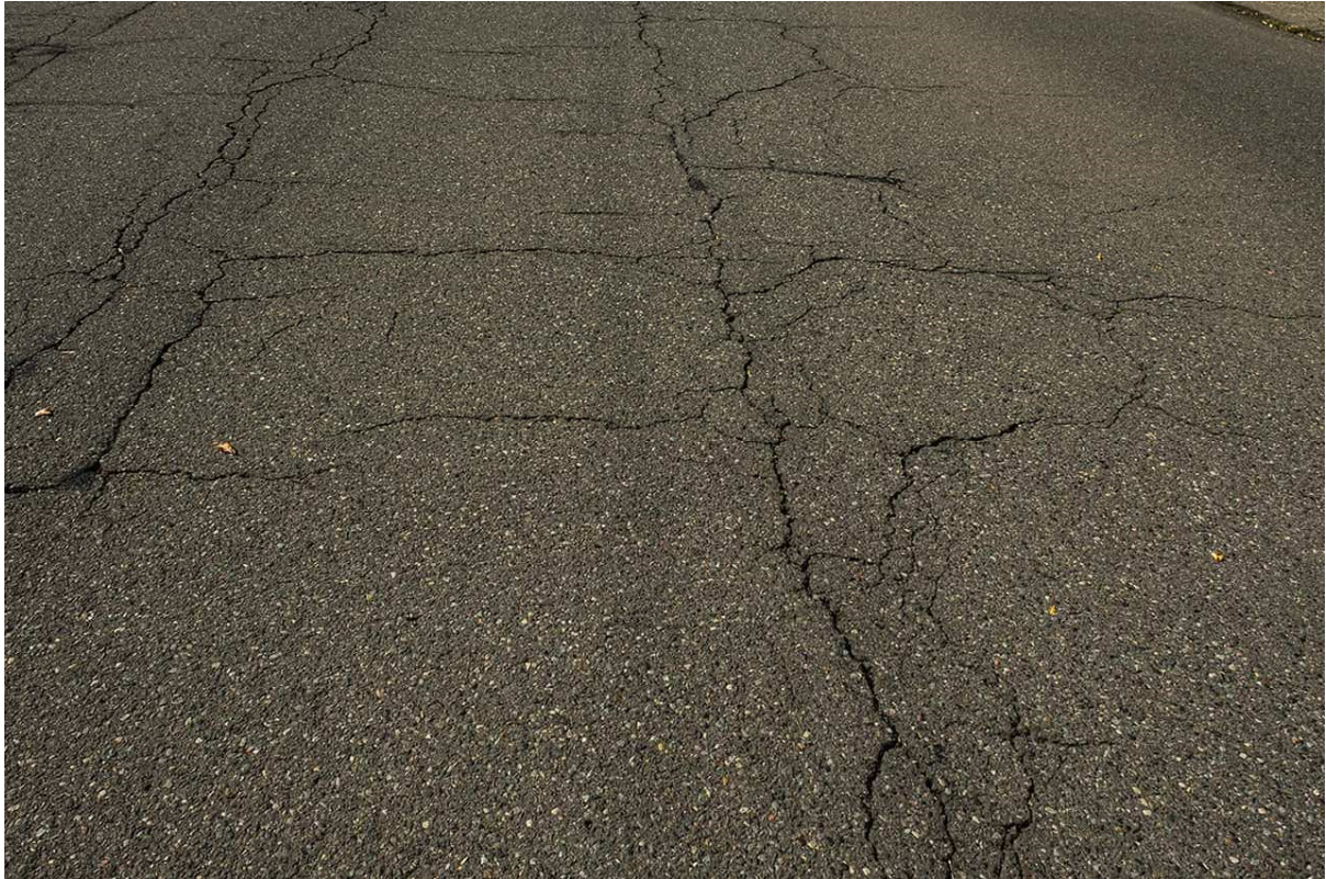
Slika 10. Oštećenje kolnika zbog razlike u temperaturi [11]
