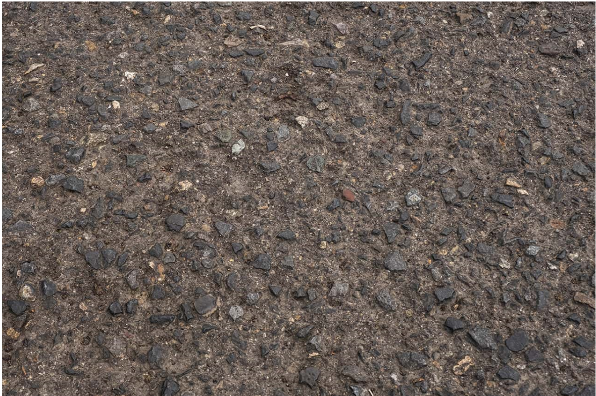
Slika 8. Mrvljenje asfalta zbog lošije kvalitete ugradnje [11]
