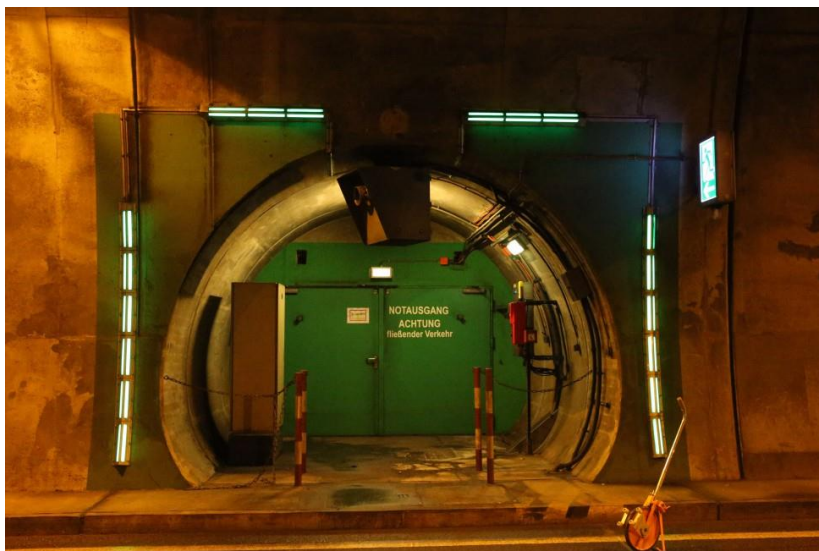
Slika 27: Izlaz za slučaj nužde u tunelu [28]
