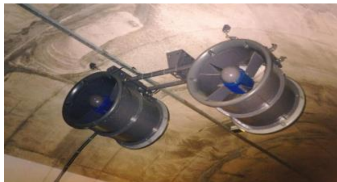
Slika 22: Ventilacija u tunelu Mala Kapela [24]
