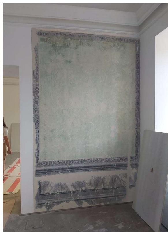
Slika 43. – Sačuvani zidni oslici na 1. katu
