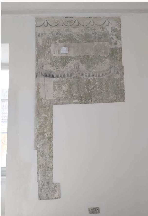
Slika 54. – Sačuvani zidni oslici na 2. katu
