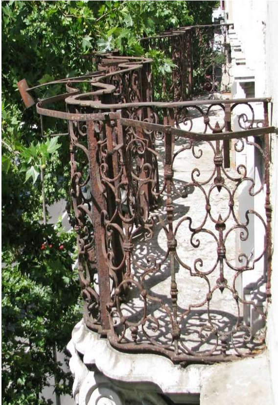
Slika 14 – Željezna ograda balkona na južnom pročelju prije obnove
