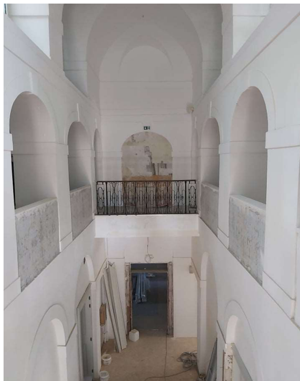
Slika 48. – Srušeni dio stropa u hodniku između 2. i 3. kata (Snimljeno sa 3. kata)
