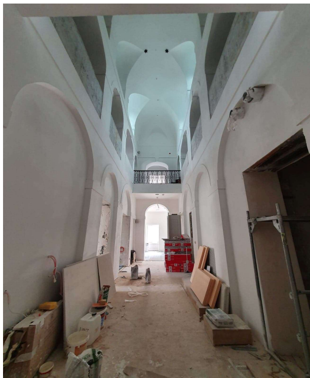
Slika 47. – Srušeni dio stropa u hodniku između 2. i 3. kata (Snimljeno sa 2. kata)
