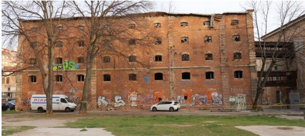
Slika 31: Oštećena Ciglena zgrada [13]
