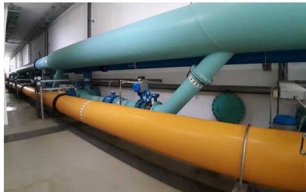
Slika 19.: Cjevovod - odvod vode iz brzih filtera, PKV Butoniga (Foto: Tamara Mošnja, 2021.)
