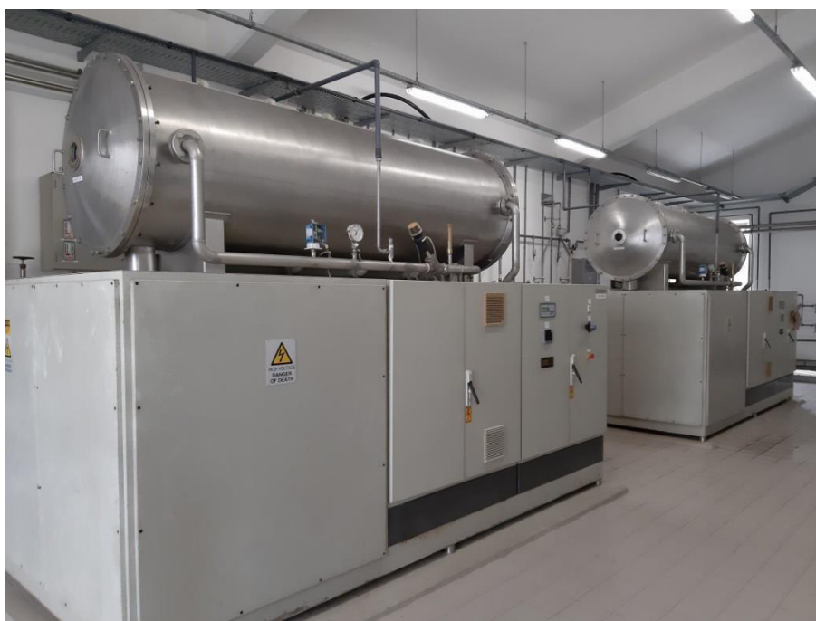
Slika 20.: Proizvodnja ozona, PKV Butoniga (Foto: Tamara Mošnja, 2021.)
