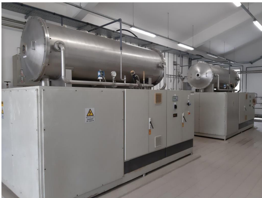
Slika 20.: Proizvodnja ozona, PKV Butoniga (Foto: Tamara Mošnja, 2021.)
