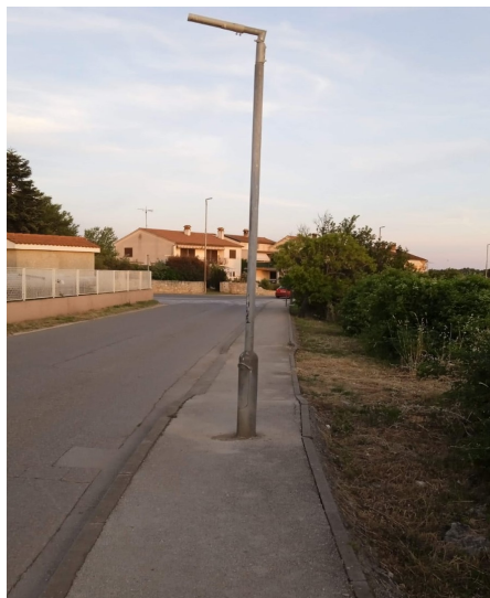
Slika 2: Loše pozicioniran stup rasvjete (Izradio Autor)
