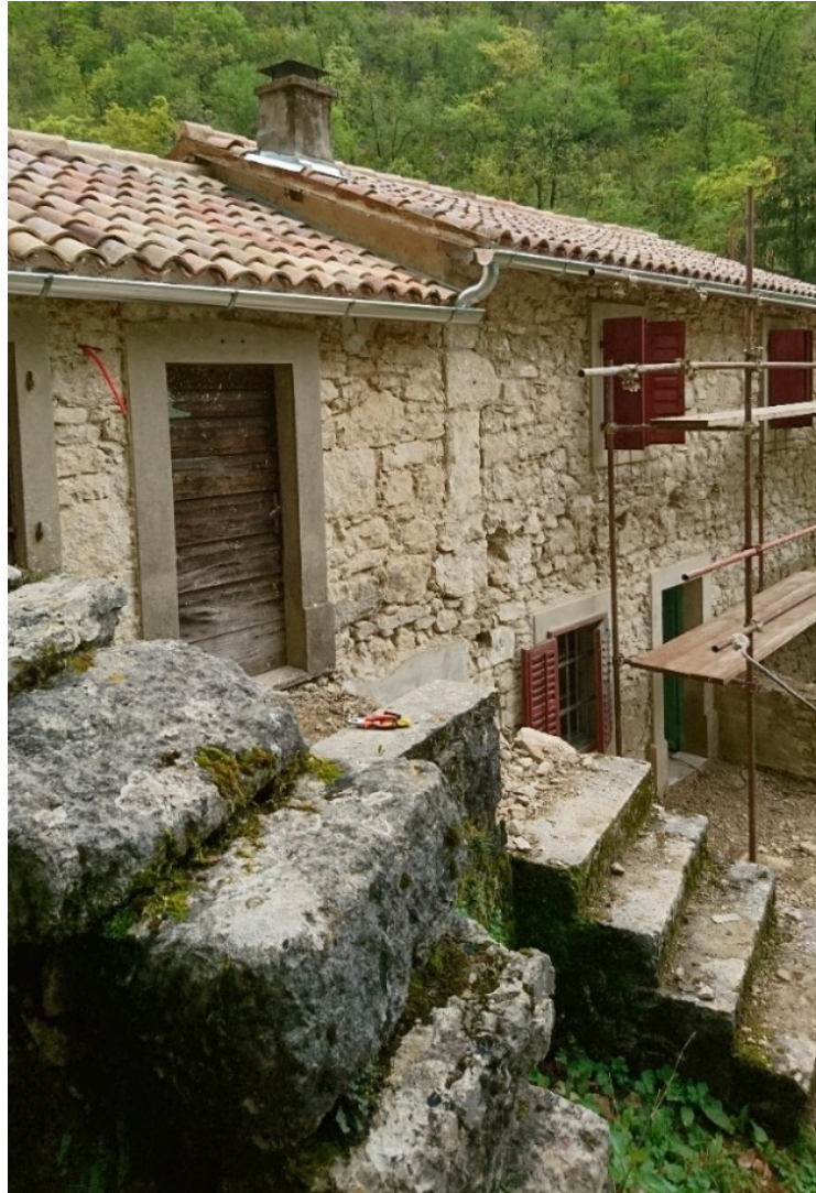
Slika 48: Objekt nakon otučenja žbuke pročelja
