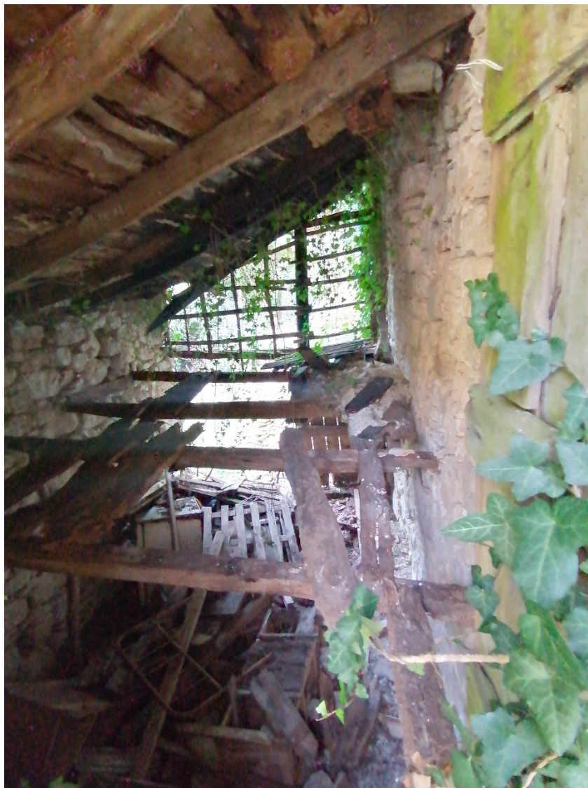
Slika 40: Krovna konstrukcija i ostaci međukatne konstrukcije štale
