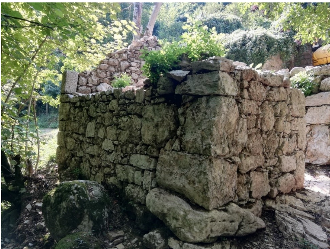
Slika 52: Mlin nakon čišćenja raslinja – pogled s južne strane
