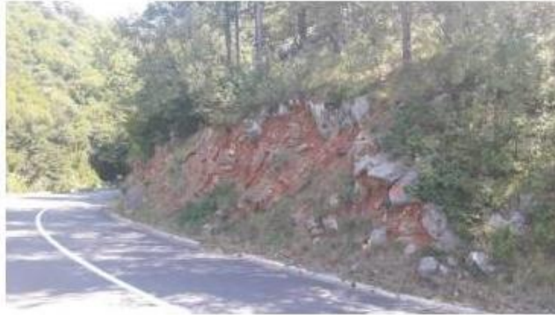
Slika 115. Predmetna kosina u sklopu inženjerskog bloka 1
