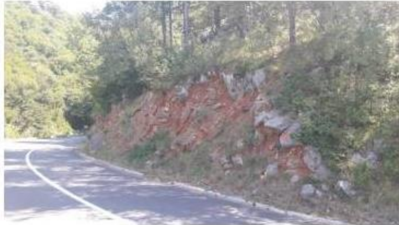
Slika 115. Predmetna kosina u sklopu inženjerskog bloka 1
