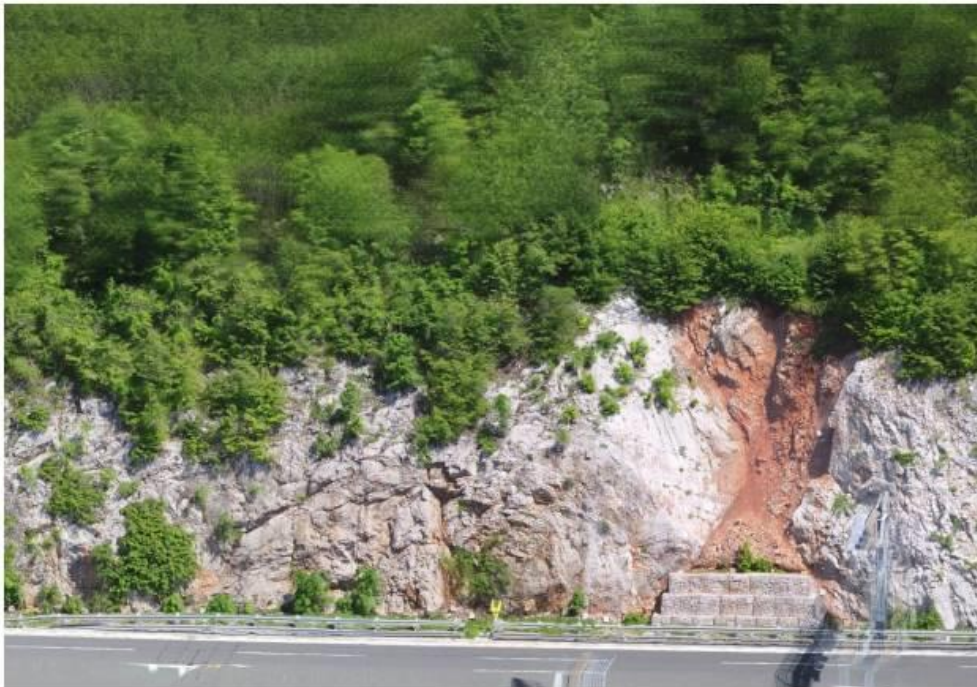
Slika 105. Pogled na stijenski pokos u km 63+500 u smjeru Rijeke
