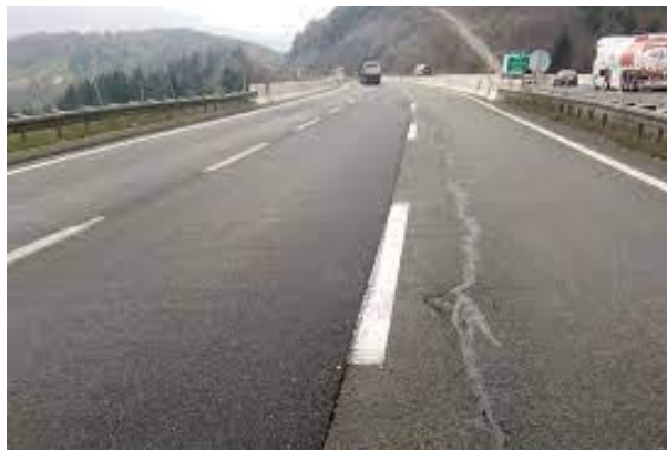
Slika 8: Oštećenje kolnika tipa uzdužna pukotina [10]
