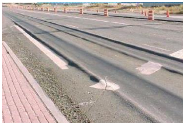
Slika 7: Oštećenje kolnika tipa kolotraženje [2]
