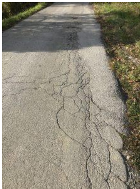
Slika 9: Oštećenje kolnika tipa blok pukotine [11]
