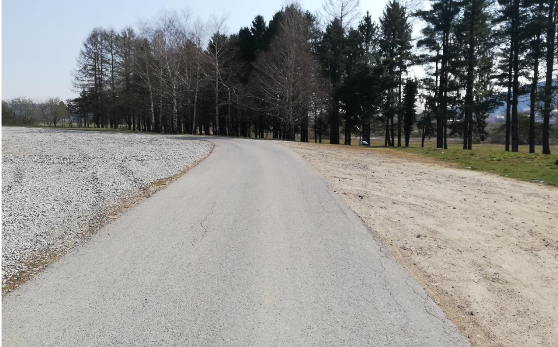
Slika 30: Stanje ceste između obalne ceste i uređenog dijela postojeće ceste
