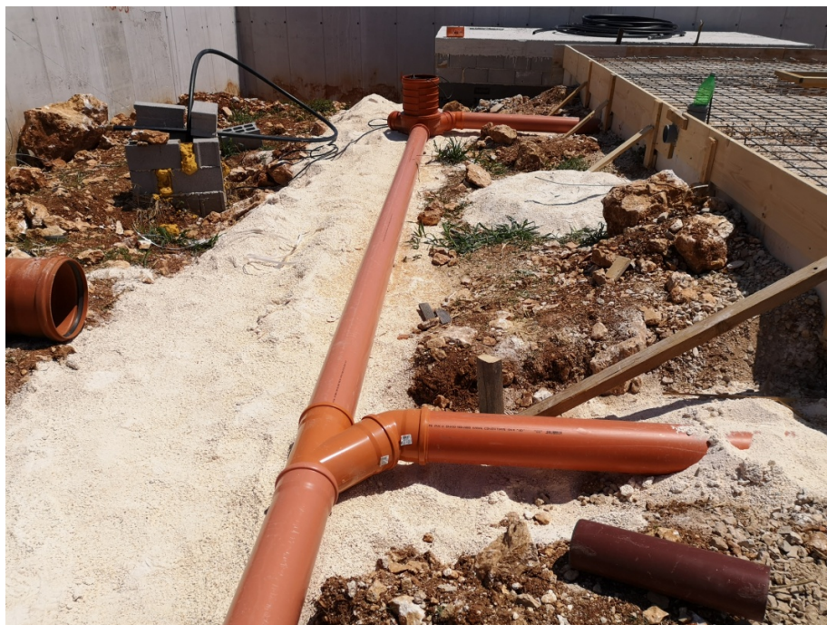
Slika 9: Kanalizacijske cijevi PVC SN4 DN160
