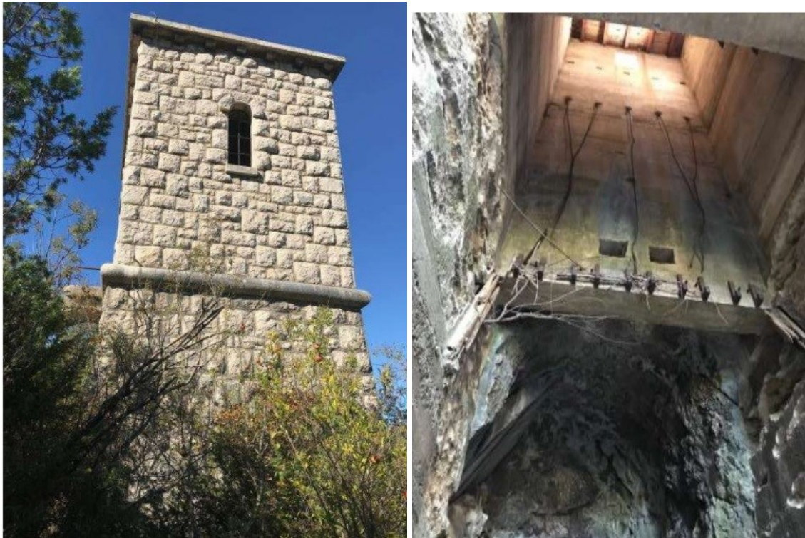
Slika 22. Građevina za manipulaciju grube rešetke u sklopu tunela Vrgorac; preuzeto sa: (EKONERG d.o.o., 2008)
