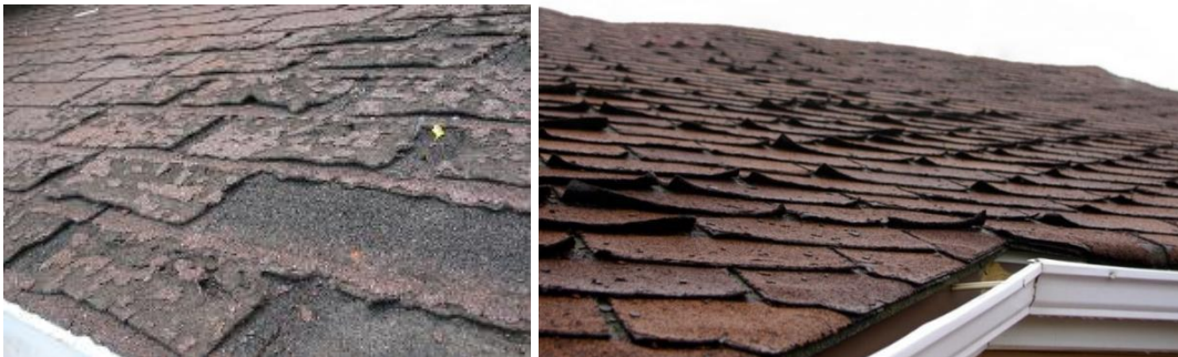
Slika 54, 55: Oštećenja krovova uslijed vanjskih utjecaja
