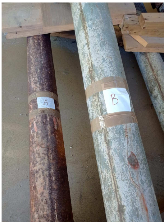
Slika 9: Stup A zahvaćen korozijom nepovoljan za provedbu ispitivanja
