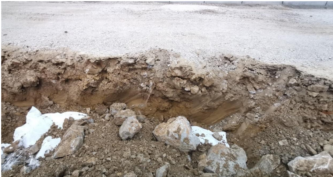
Slika 36. Loše temeljno tlo prometnice (fotografija autora)
