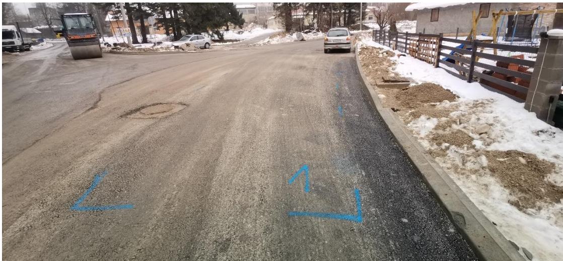
Slika 56. Prikaz jedne od lokacija pucanja asfaltnog sloja (fotografija autora)
