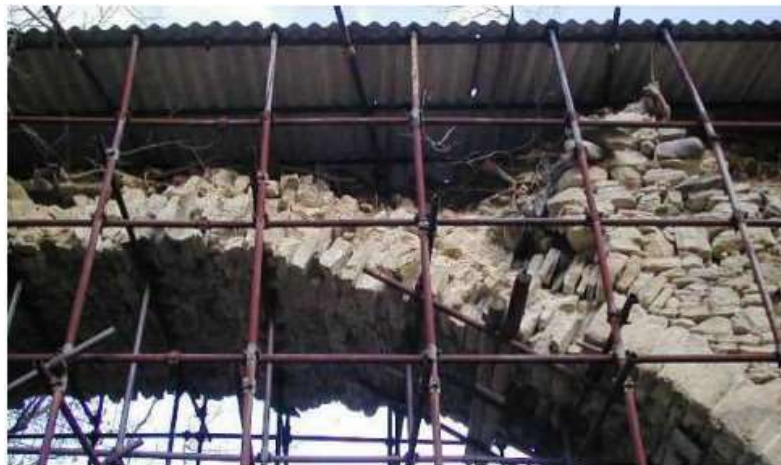
Slika 41. Stanje urušavajućeg mosta [7]
