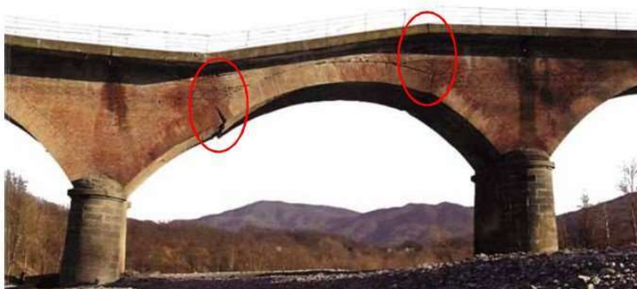
Slika 11. Pojava zglobova na lučnom mostu [7]
