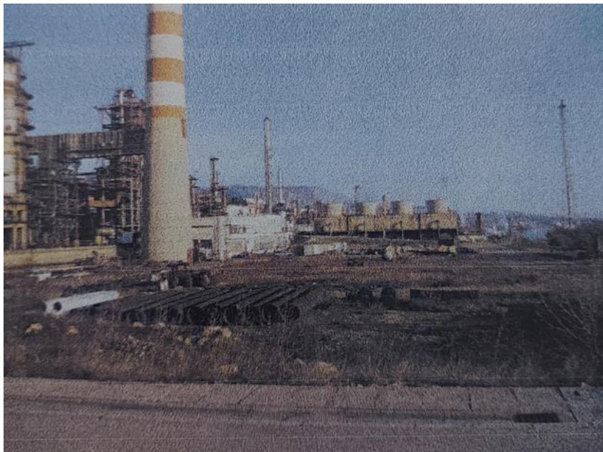
Slika 11: Površina za izgradnju Hidrokreking kompleksa (Izvor: Studija o utjecaju na okoliš za postrojenje Hidrokreking kompleksa i pomoćnih jedinica u INA d.d. – Rafinerija nafte Rijeka, 2006.)
