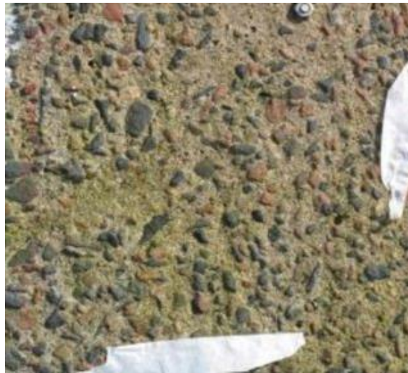
Slika 11. Abrazija površine betona (3 milimetra/godina) [13]
