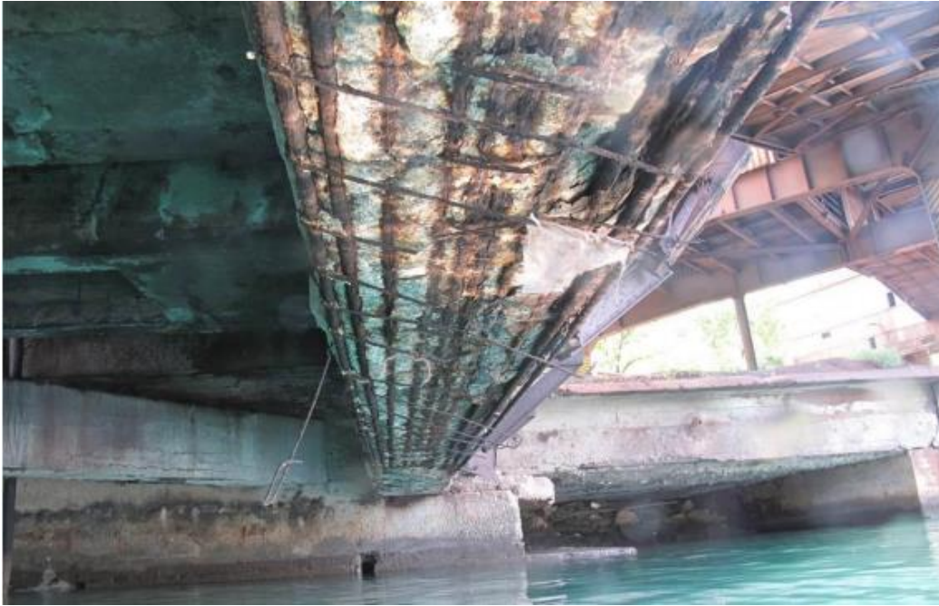
Slika 5. Vrlo jako oštećenje terminala Podbok u Bakru [10]
