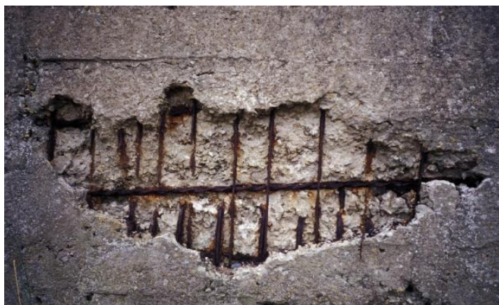
Slika 8. Odlamanje zaštitnog sloja betona [13]
