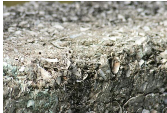
Slika 10. Školjke na površini betona [13]
