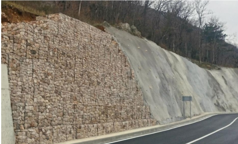
Slika 7. Primjer obložnog zida izvedenog uz prometnicu (foto: Renar d.o.o. i Neuron d.o.o., 2004.)
