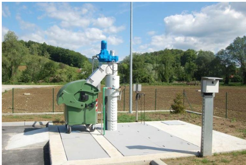
Slika 5: Ulazna crpna stanica
