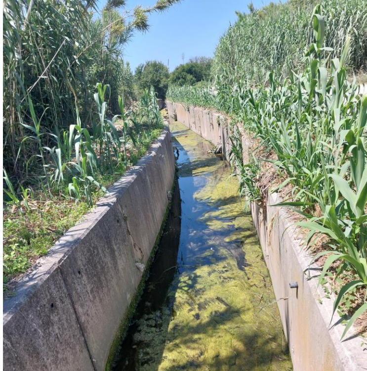
Slika 75: Odvodni kanal obrastao bujnom vegetacijom trske [fotografija: autor, 15.07.2023.]
