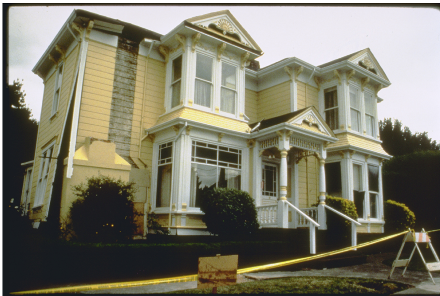
Slika 2.9: Oštećena viktorijanska kuća, Fernadel, Kalifornija, 1992. god. [9]
