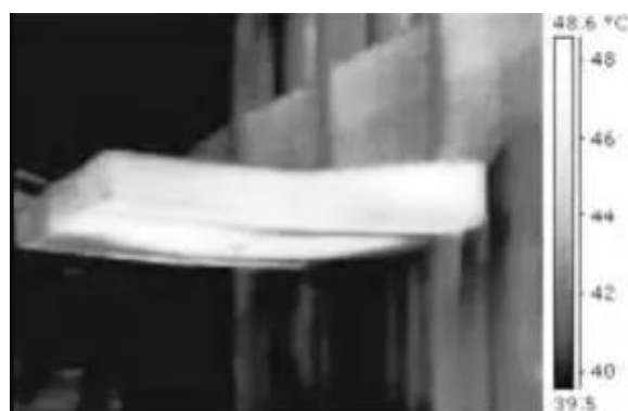
Slika 27 Termografija prodiranja vlage u nadstrešnicu.[15]
