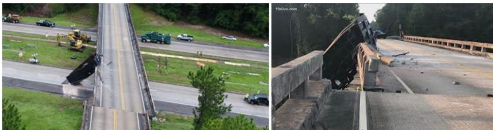
Slika 2: Pomak mosta nakon udara kamiona [3]
