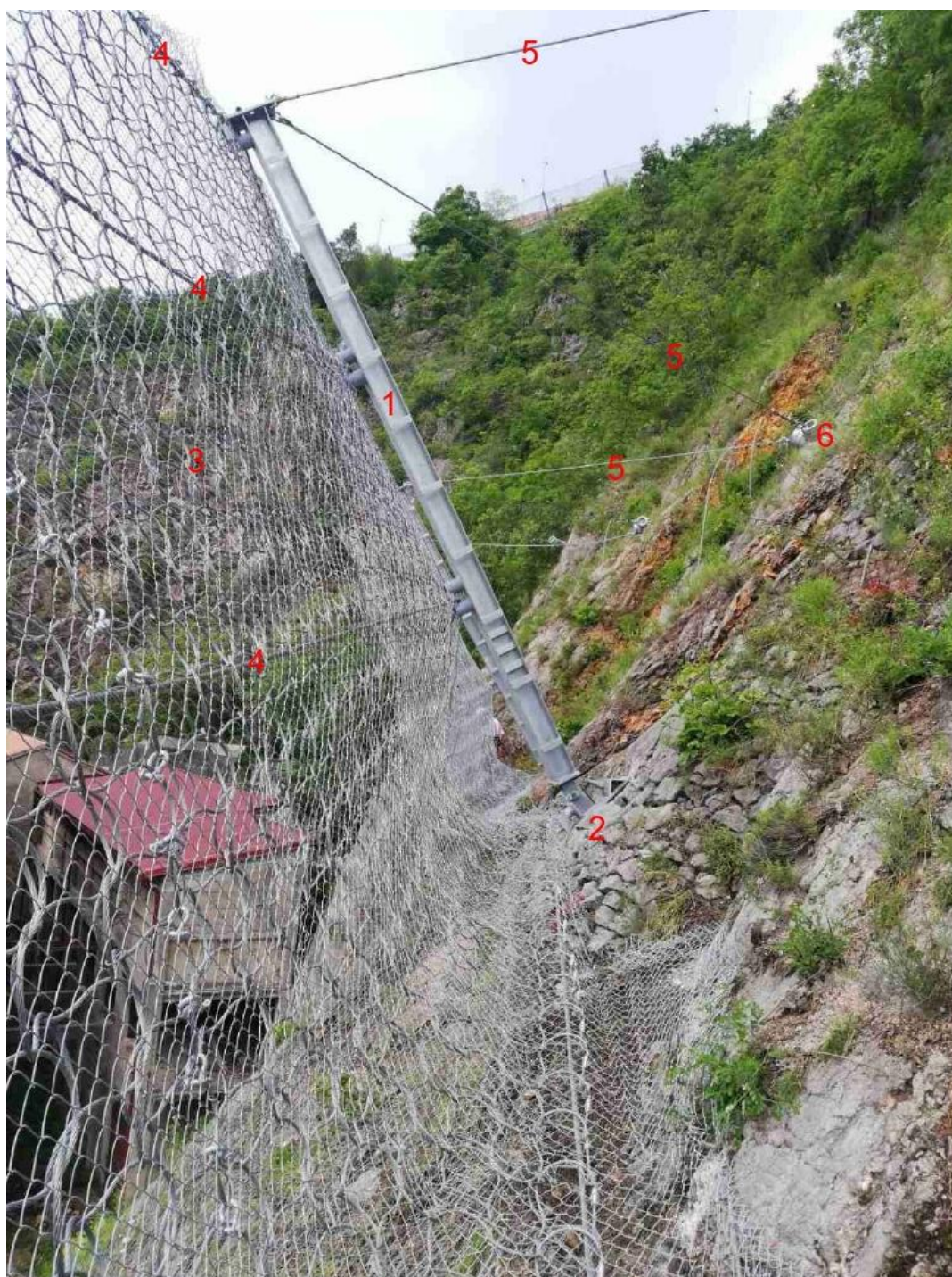
Slika 21. Elementi barijere za zaštitu od odrona; 1-čelični stup, 2-temelj s podložnom pločom, 3-mreža, 4-nosiva užad, 5-zatezna užad, 6- usidreni kočioni prstenovi
