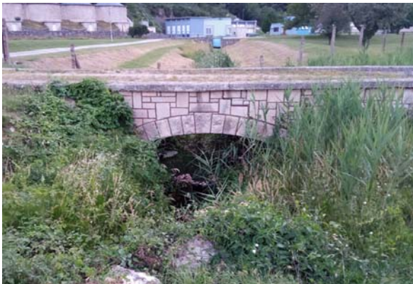
Slika 40. Cestovi propust (pc2)
