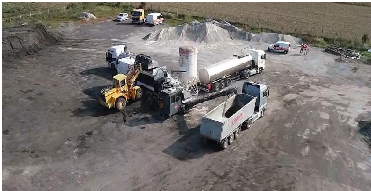
Slika 16. Postrojenje za proizvodnju hladno reciklirane mješavine metodom in-plant
