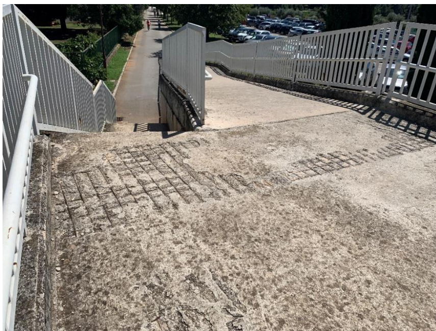
Slika 71: Istrošeni beton na mostu u Prvomajskoj ulici
