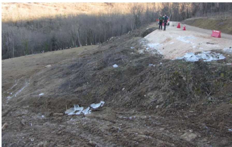
Slika 4. Oštećenje prometnice LC50059 uslijed klizanja [15]
