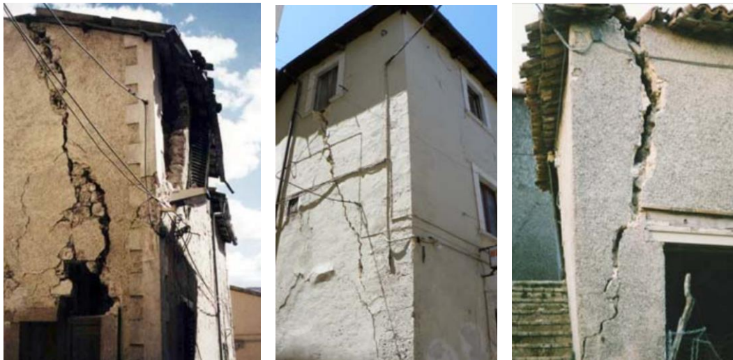
Slika 4. Prevrtanje zida pročelja s bočnim dijelom zida [1]
