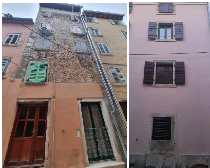
Slika 21: Neprimjerena rekonstrukcija otvora (foto autorica, 2023.) 159
