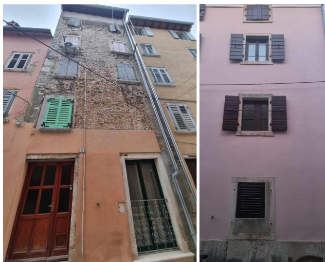
Slika 21: Neprimjerena rekonstrukcija otvora (foto autorica, 2023.) 159
