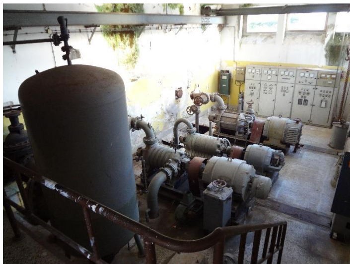
Slika 2.8. Unutrašnjost stare crpne stanice (izradio autor)
