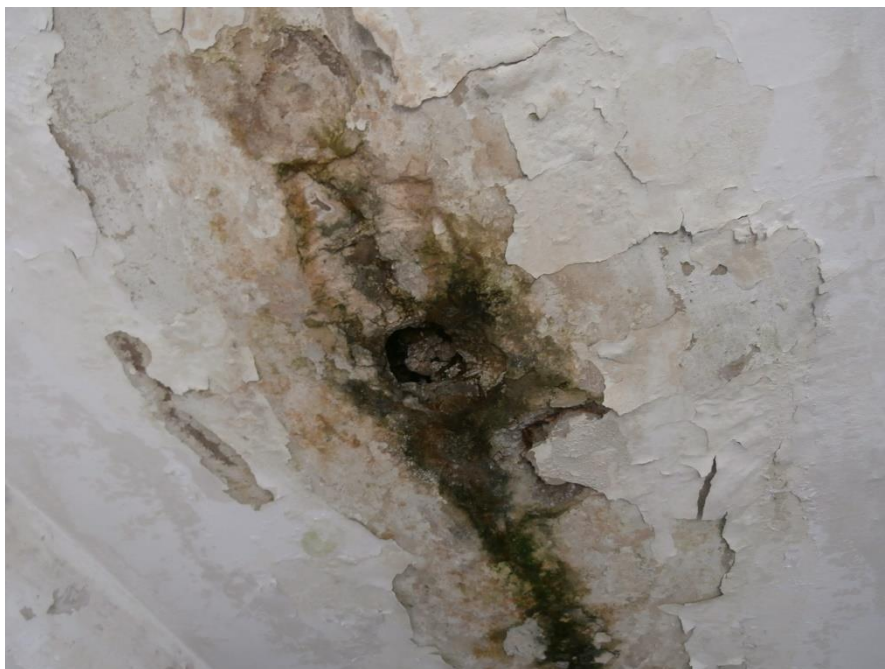
Slika 27 Vidljiva korozija armature u stropnoj ploči te opadanje zaštitnog sloja betona zbog velike količine vlage [13]
