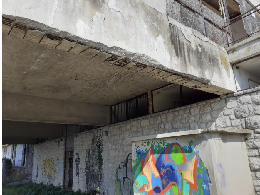
Slika 26 Vanjski dijelovi konstrukcije na kojima je vidljiva armatura koja je korodirala i nema zaštitnog sloja betona [13]
