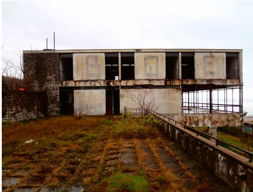
Slika 28 Pogleda na konstrukcije sa vanjske strane gdje je vidljivo korodiranje armature i čeličnih dijelova konstrukcije [13]
