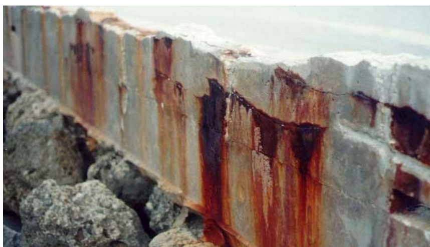
Slika 11 Pukotine uslijed korozije armature [14]
