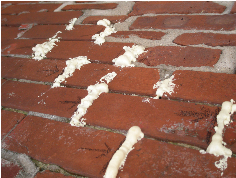
Slika 1.1: Reparacija pukotina poliuretanskom pjenom (Kevin Farley [1])
