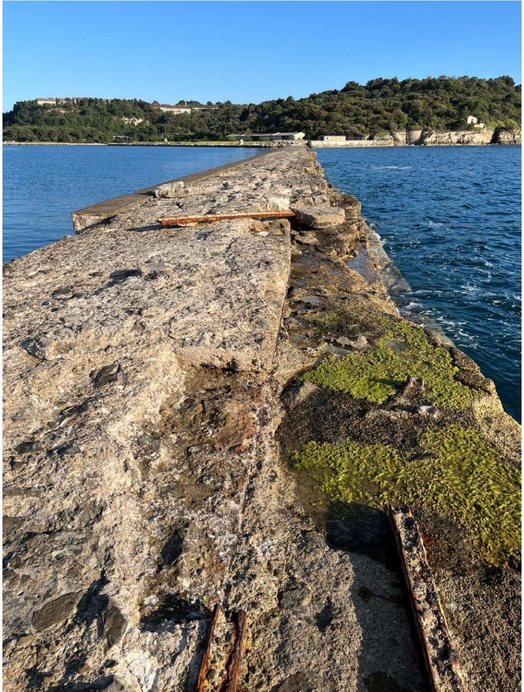
Slika 16: Detalj oštećenja vanjske strane lukobrana
