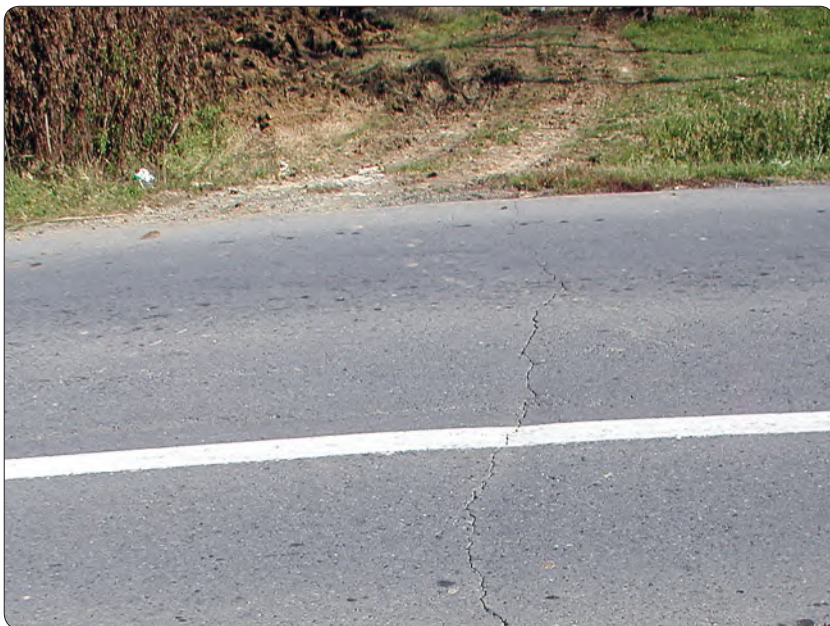
Slika 4.3.1. Poprečna pukotina, S1
