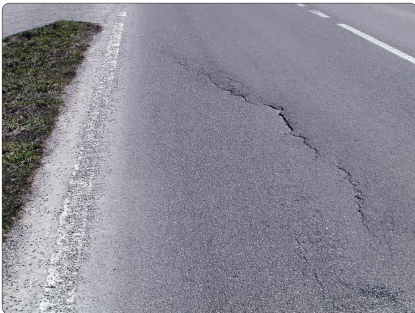
Slika 4.6.1. Pukotina uslijed slijeganja, S1
