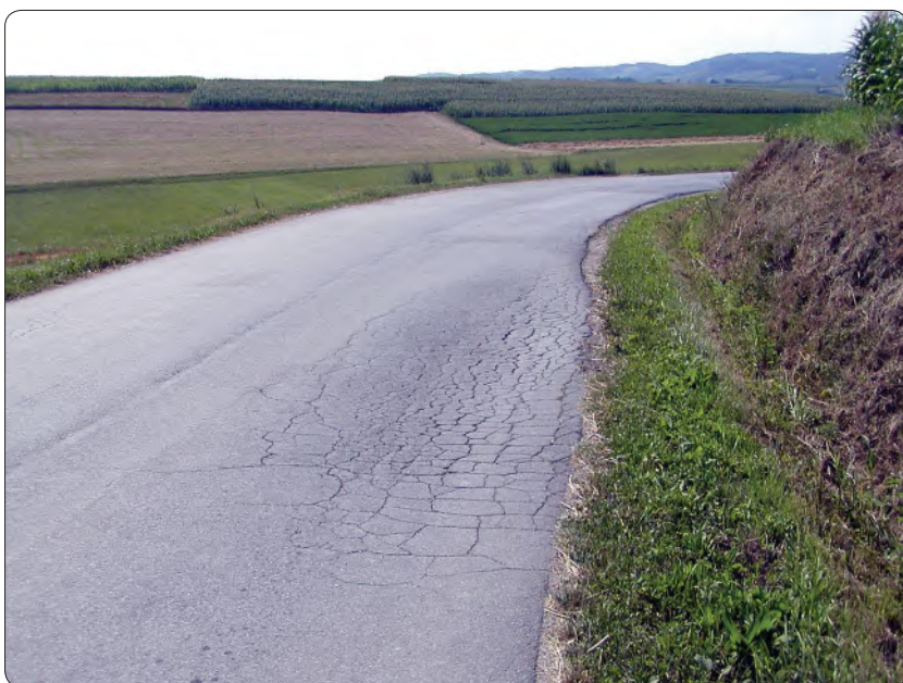
Slika 3.6.3. Lokalno udubljenje, S3
