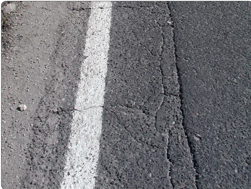
Slika 4.7.2. Pukotine uz rub kolnika, S2
