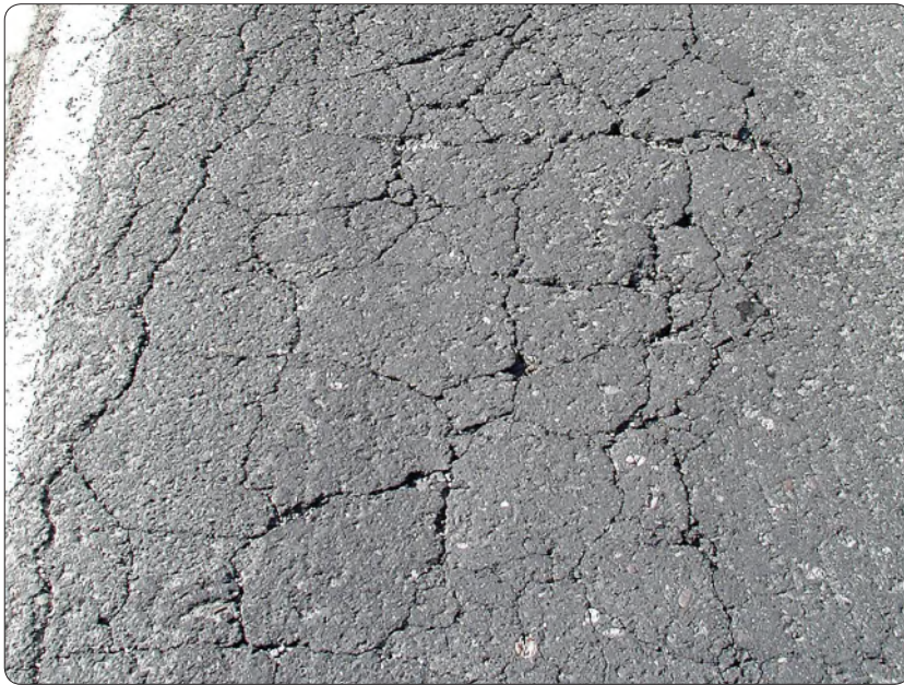
Slika 4.1.2. Mrežaste pukotine, S2
