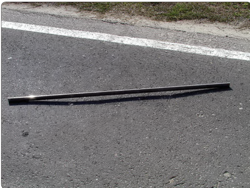
Slika 3.6.1. Lokalno udubljenje, S1
