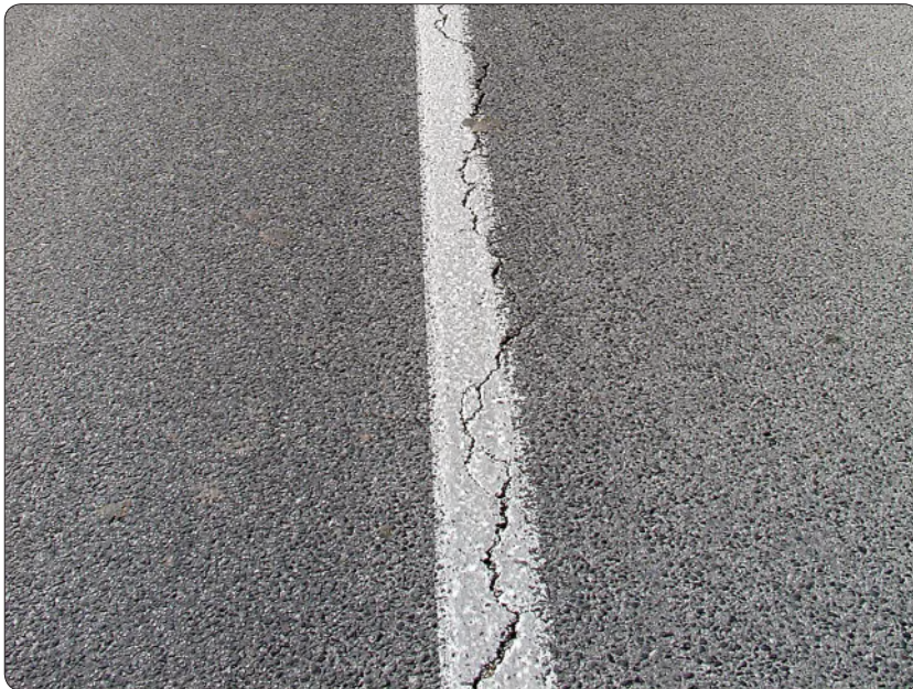
Slika 4.2.2. Uzdužna pukotina, S2
