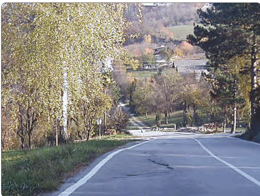
Slika 4.6.2. Pukotina uslijed slijeganja, S2
