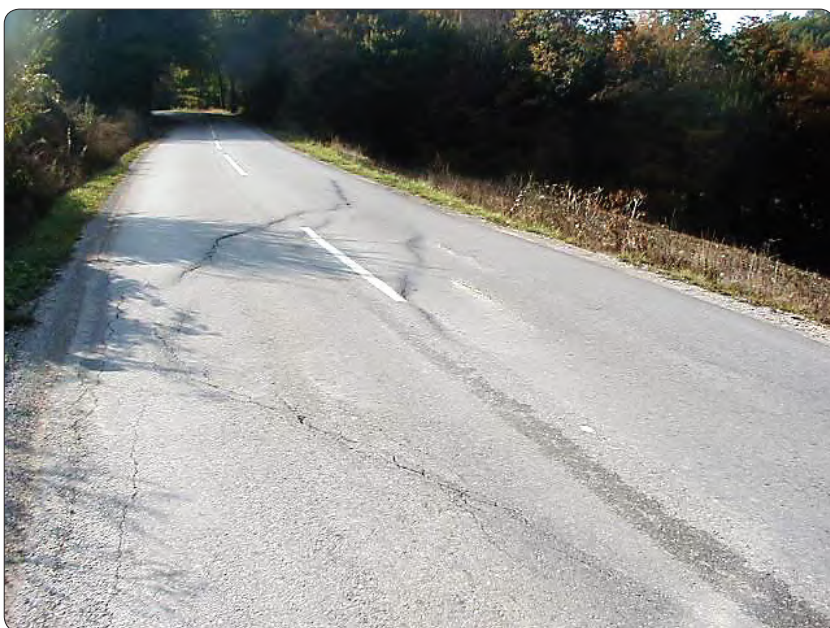
Slika 4.6.3. Pukotina uslijed slijeganja, S3
