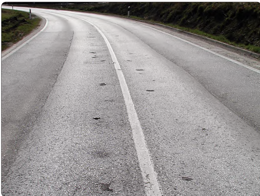
Slika 2.1.1. Odvajanje/otkidanje habajućeg sloja
