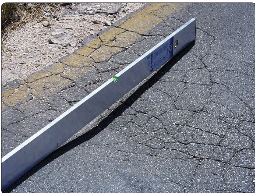
Slika 3.6.2. Lokalno udubljenje, S2
