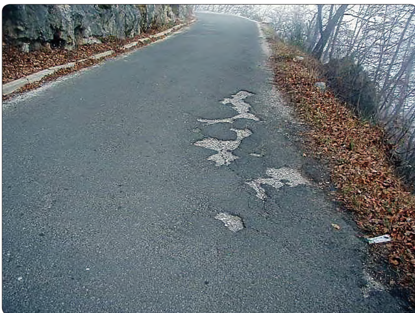
Slika 2.1.2. Odvajanje/otkidanje habajućeg sloja
