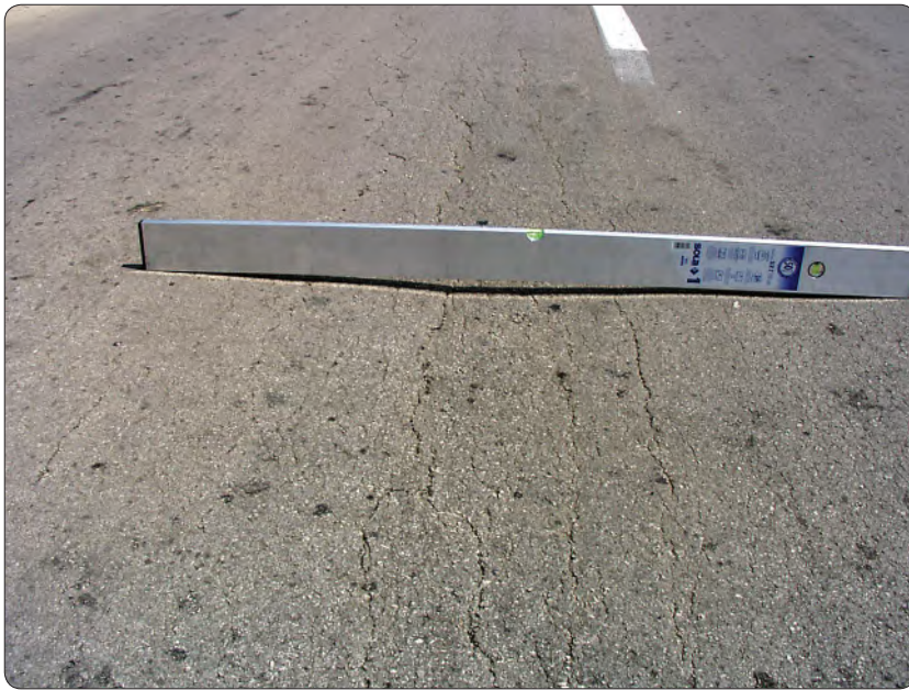
Slika 4.4.1. Pukotine u tragovima kotača, S1
