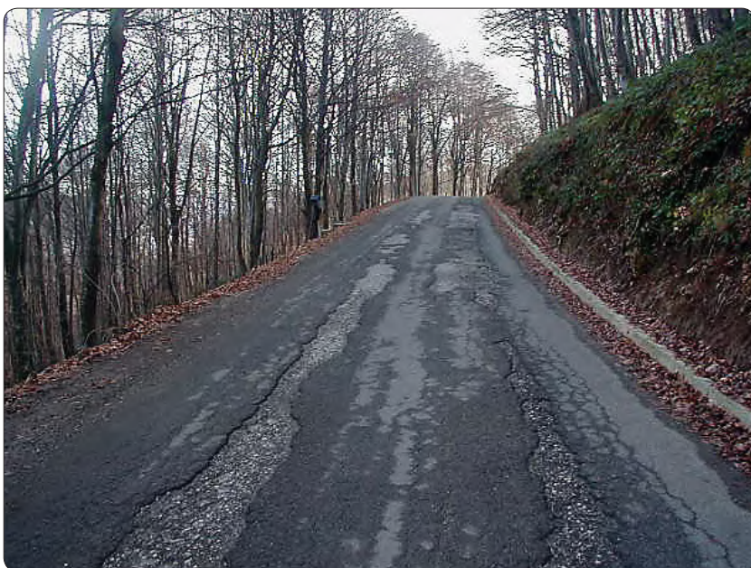
Slika 2.1.3. Odvajanje/otkidanje habajućeg sloja
