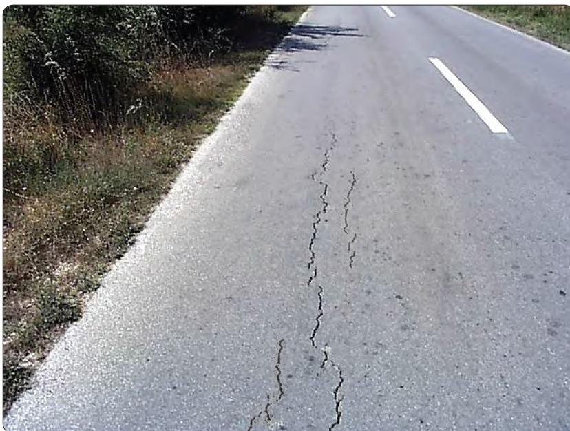
Slika 4.2.3. Uzdužna pukotina, S3
