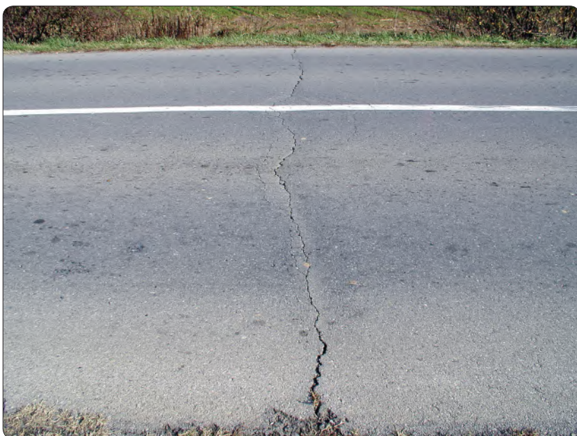
Slika 4.3.2. Poprečna pukotina, S2
