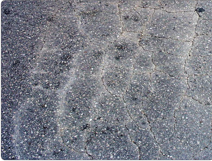
Slika 4.1.1. Mrežaste pukotine, S1
