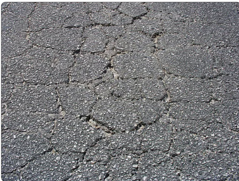
Slika 4.1.3. Mrežaste pukotine, S3
