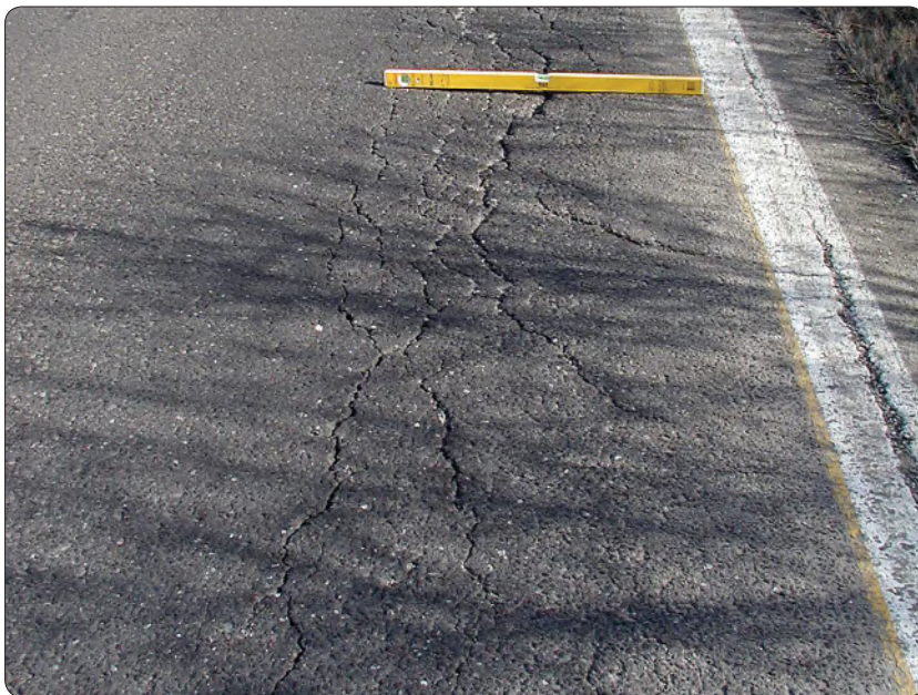
Slika 4.4.2. Pukotine u tragovima kotača, S2
