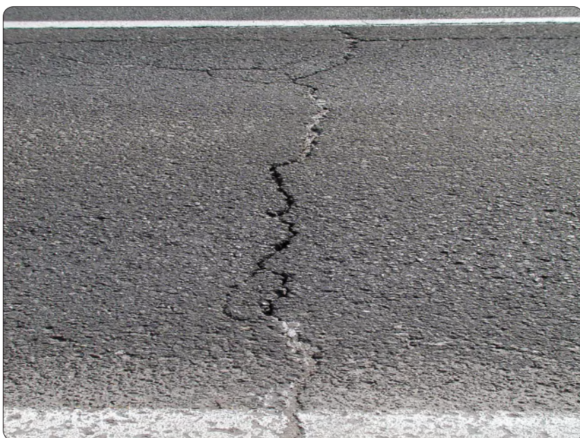
Slika 4.3.3. Poprečna pukotina, S3
