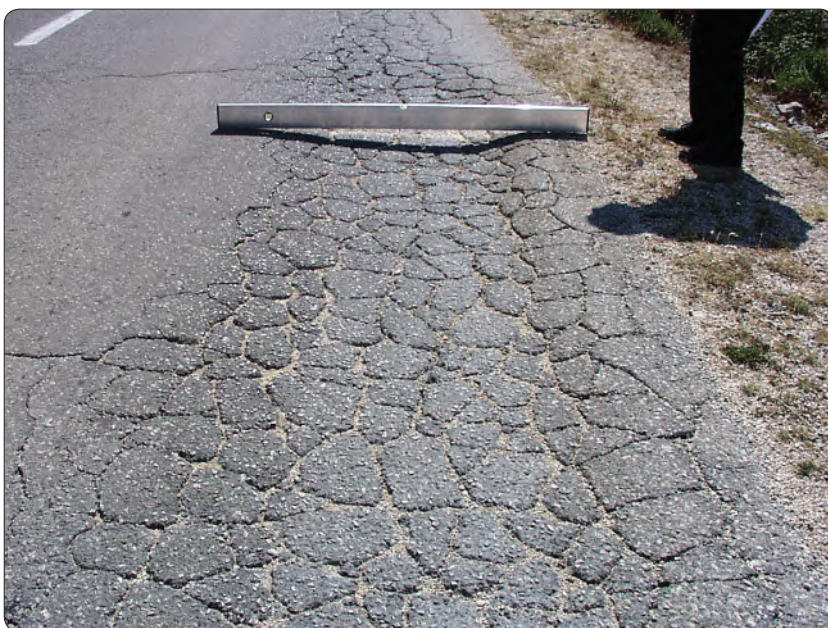
Slika 4.4.3. Pukotine u tragovima kotača, S3
