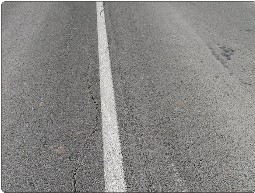
Slika 4.2.1. Uzdužna pukotina, S1
