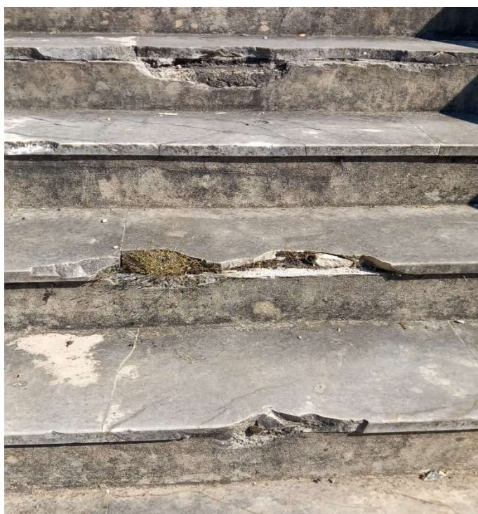
Slika 77: Detalj oštećenja nastupnih ploha stuba [autorica]
