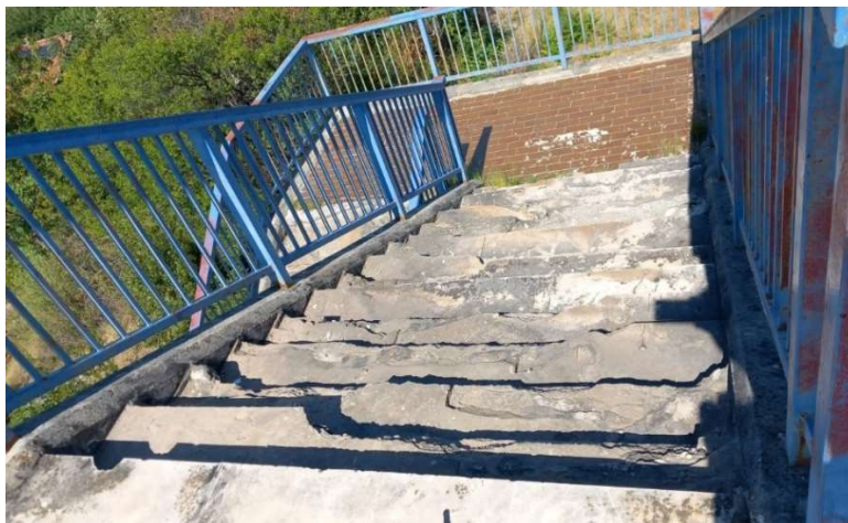
Slika 66: Detalj oštećenja pojedinih stuba [autorica]
