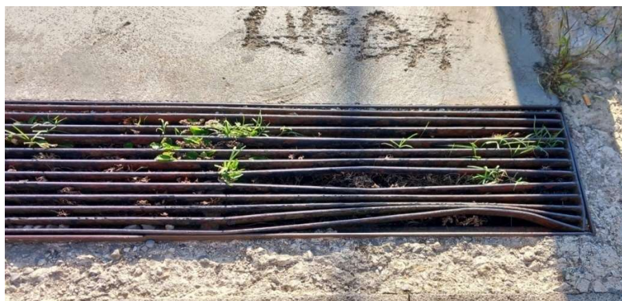
Slika 84: Detalj oštećenja hodne plohe i rešetke [autorica]
