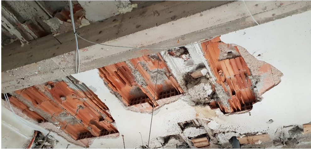
Slika 10: Loše stanje međukatne konstrukcije. Vidljiva nova AB greda kao dio ojačanja. [ Izvor: autor ]
