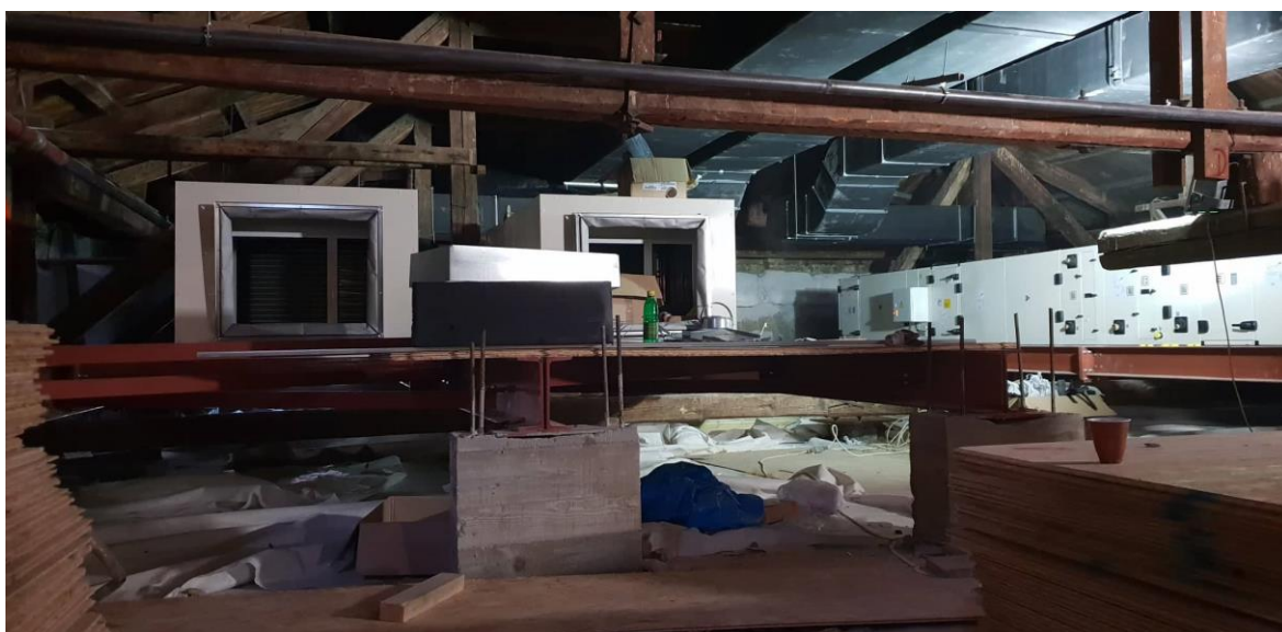
Slika 42: Ventilacijske jedinice u potkrovlju [Izvor: Autor]
