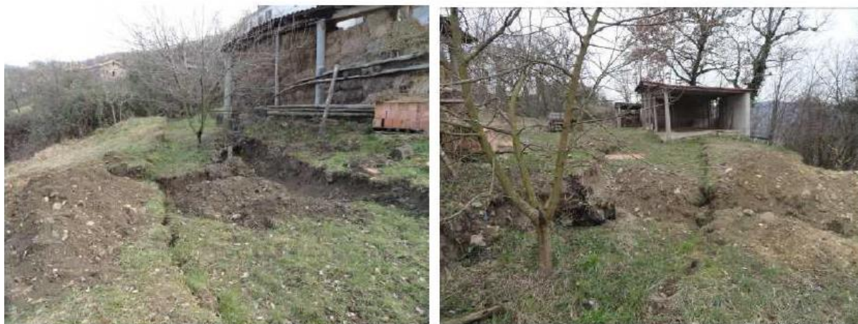
Slika 27. Glavna pukotina (lokacija sjeverno od ceste) (preuzeto iz Bernat, 2011).
