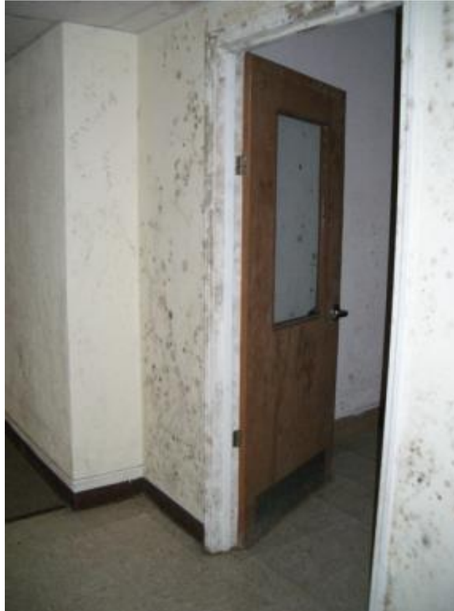
Slika 2: Rast plijesni na površini obojene gips ploče i obloge [5]
