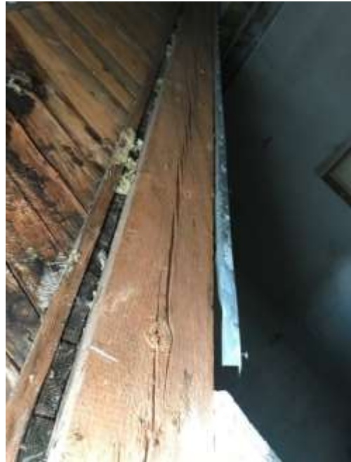
Slika 4.b: Površinske pukotine od skupljanja
