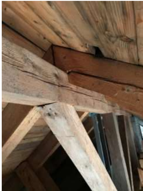
Slika 6: Konstrukcijsko oštećenje zbog stepenastog zasijecanja kombinirano s utjecajem vlage (spoj na sljemenu)
