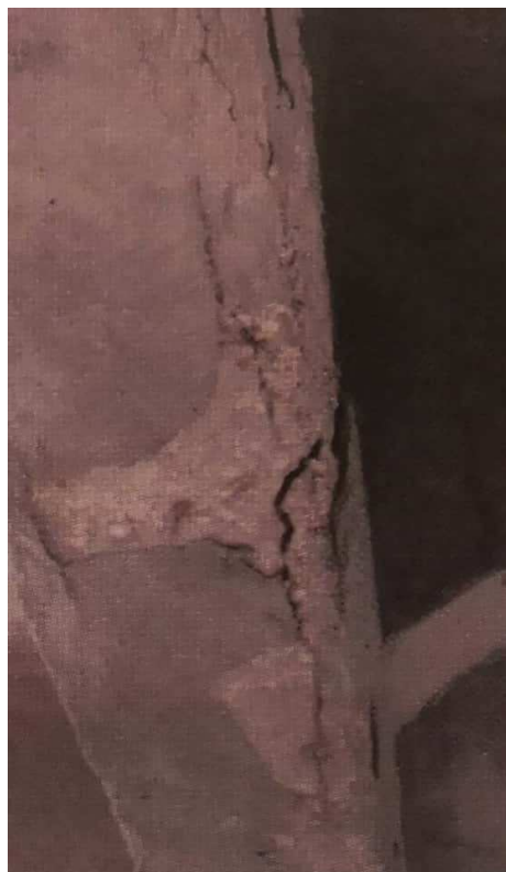
Slika 9. Odlamanje zaštitnog sloja betona [4]
