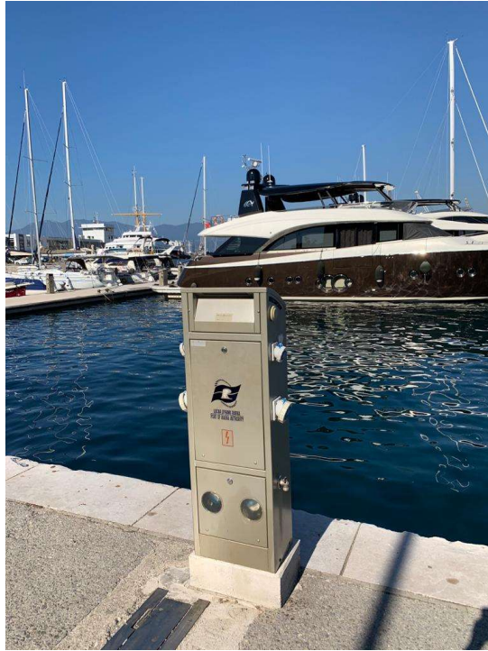
Slika 44. Energetski razvodni ormarić
