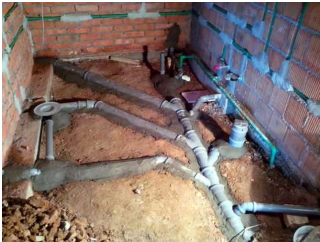
Slika 13. Vodovodne i kanalizacijske instalacije
