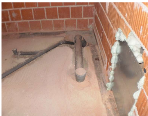
Slika 12. Kanalizacijske instalacije kupaonice
