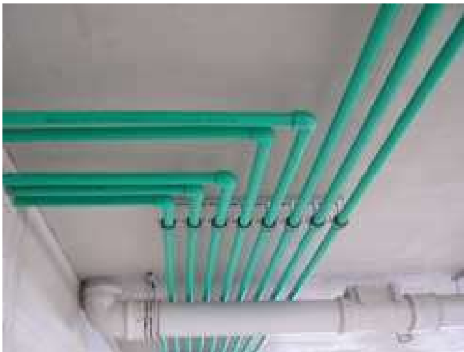
Slika 2. Otvoreni razvod vodova
