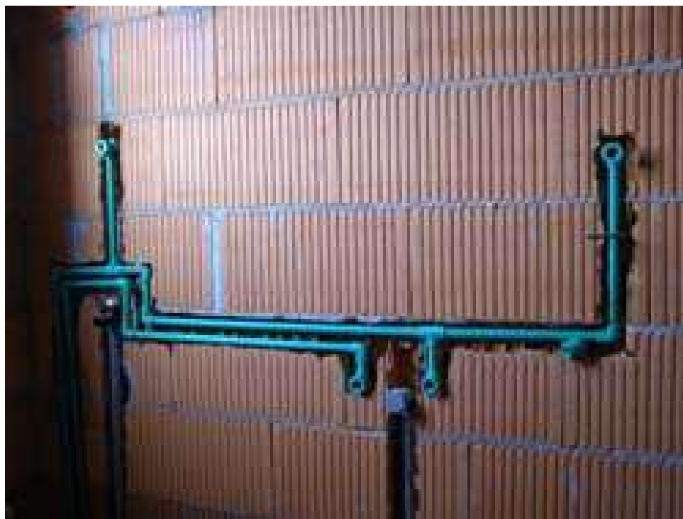
Slika 3. Zatvoreni razvod vodova hladne i tople vode
