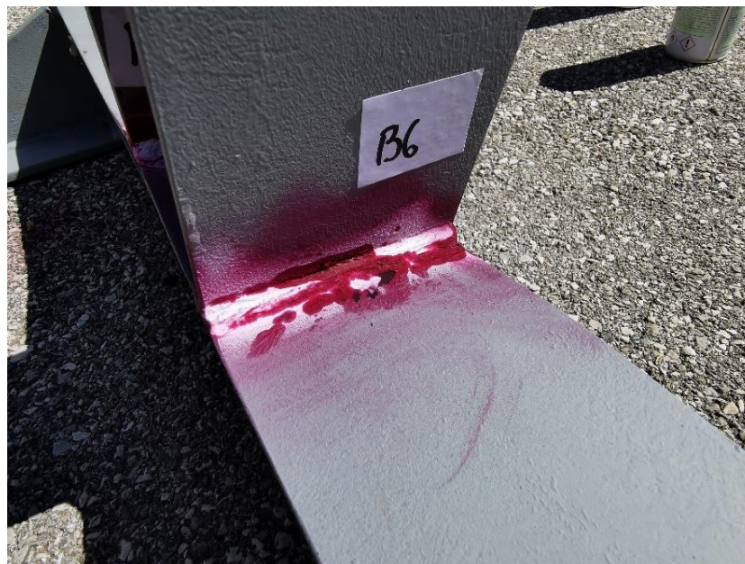
Slika 37: Pukotina na zavaru B6 (Izradio autor)
