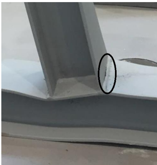
Slika 28: Pukotina na zavarenom uzorku B [24]
