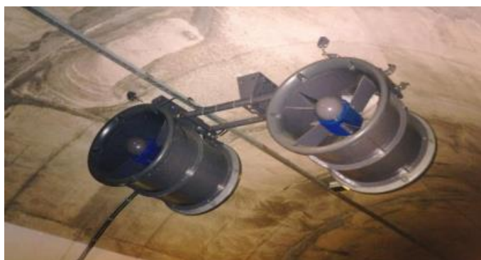
Slika 22: Ventilacija u tunelu Mala Kapela [24]
