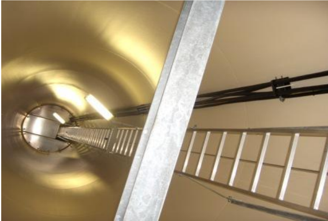
Slika 45. Unutrašnjost stupa vjetroagregatora
