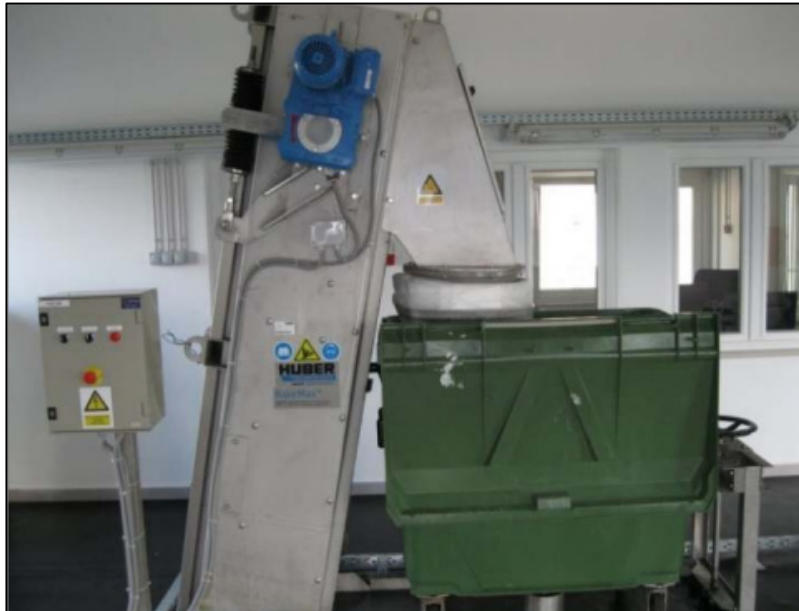
Slika 9: Automatska gruba rešetka [10]
